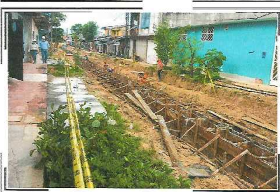
ENCOFRADO DE PARED DE CANAL DE 0.60 X 0.60M EN LA CA. QUIÑONES ENTRE AV. DEL EJERCITO Y CA. ABTAO
