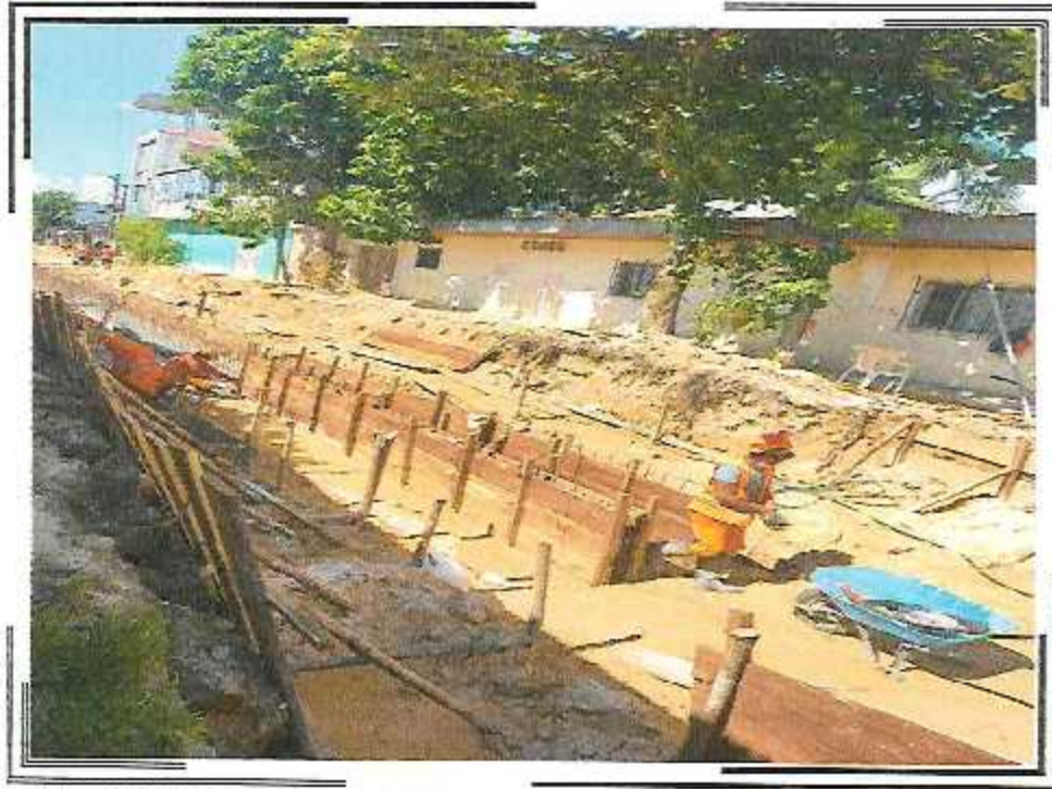
ENCOFRADO DE PARED DE CANAL DE 0.60 X 0.80M EN LA CA. QUIÑONES ENTRE AV. DEL EJERCITO Y CA. ABTAO
