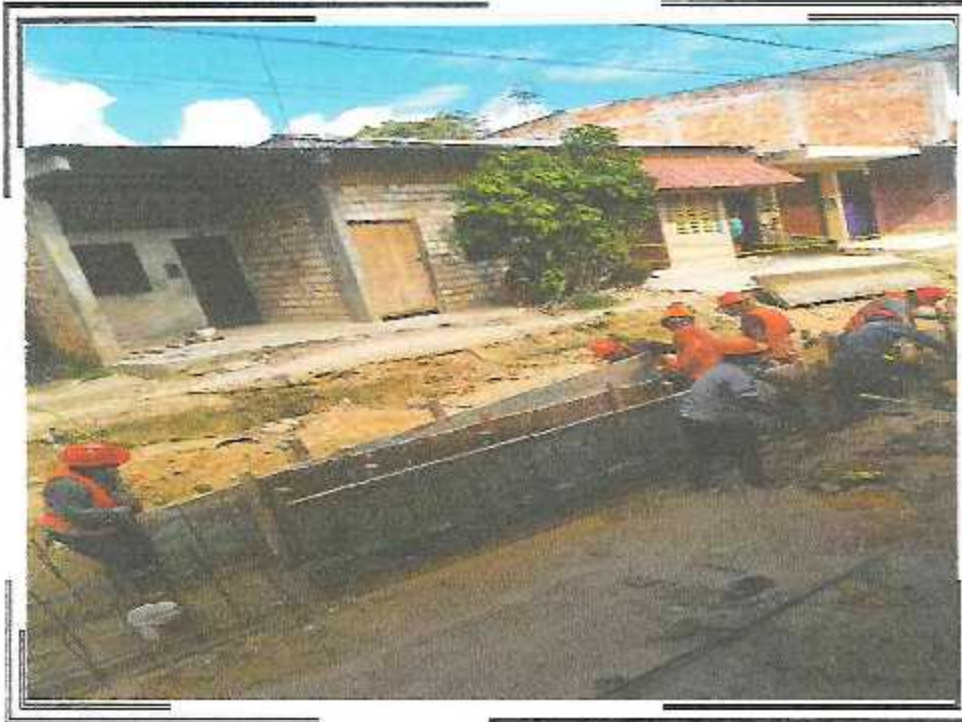
ENCOFRADO DE PARED DE CANAL DE 0.50 X 0.50M EN LA CA. QUIÑONES ENTRE 2 DE MAYO HY PSJ. MIAMI
