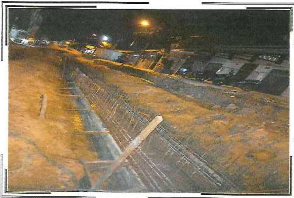
VACEADO DE LOSA DE FONDO EN CANAL DE 0.50 X 0.50 M EN EL TRAMO CA. QUIÑONES ENTRE CA. ABTAO Y CA. DOS DE MAYO
