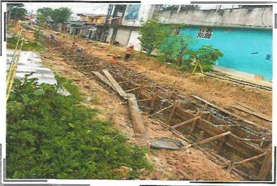
ENCOFRADO DE PARED DE CANAL DE 0.60 X 0.60M EN LA CA. QUIÑONES ENTRE AV. DEL EJERCITO Y CA. ABTAO
