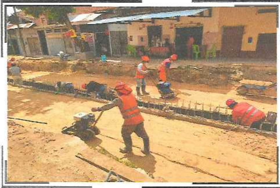
COMPACTACION DE RELLENO DE LOS LATERALES DEL CANAL DEL PSJ. QUIÑONES TRAMO II
