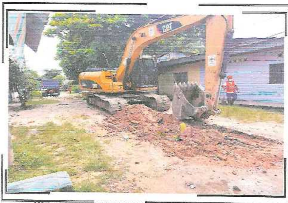
CORTE DE TERRENO A NIVEL DE SUBRASANTE CON MAQUINARIA CALLE QUINONES ENTRE AV. DEL EJERCITO / CA. ABTAO
