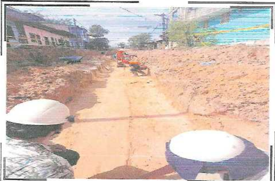
COMPACTACION DE CANA DE ARENA PARA CANAL PROYECTADO EN EL TRAMO DE CA. QUIÑONES ENTRE AV. DEL EJERCITO / CA. ABTAO
