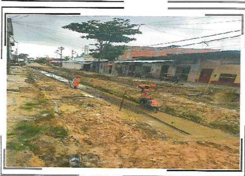
COLOCACION DE ACERO DE CANAL DE 0.50 X 0.50m EN LA CA. QUINONES ENTRE CA. ABTAO Y CA. DOS DE MAYO
